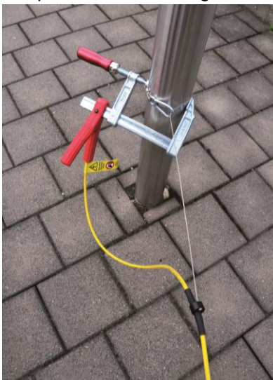
Erdung am Mast mit Hilfe einer Schraubzwinde
